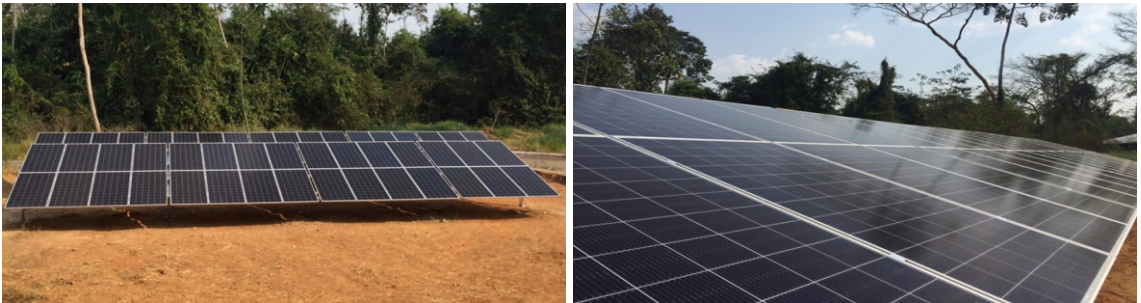
Figura 22: Planta fotovoltaica II, localizada ao lado do Ceeac
