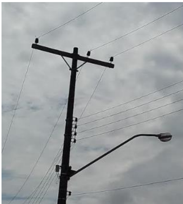
Figura 24: Estrutura superior N1 e lateral S4 tangente
